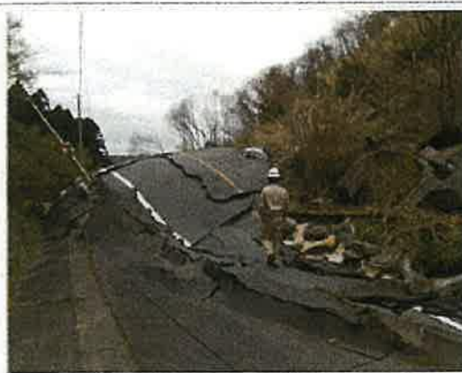
余震による県道の隆起（いわき市浪江町）
