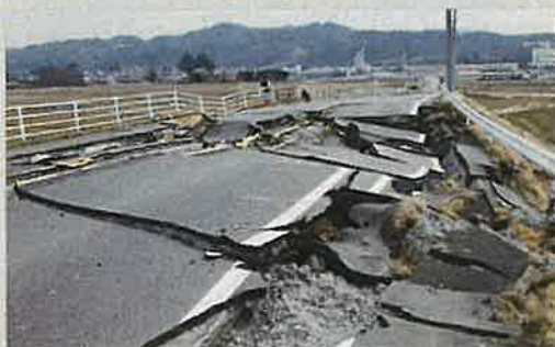
市道富士内・上沢線。アスファルトは鉋細工を壊したようにバラバラに
