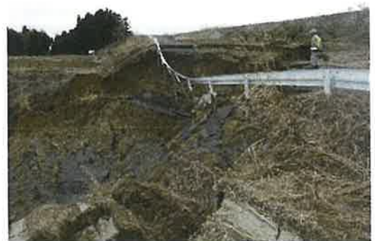
（崩落した町道西方後作線の区間）
