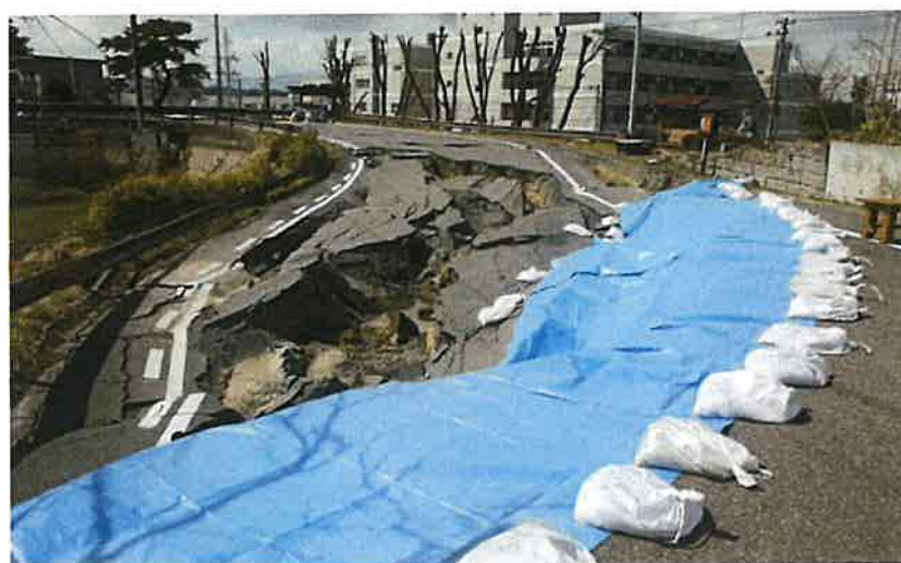
道路の被災状況（八幡山地区内）
