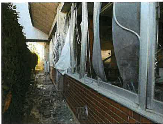
市役所庁舎の被災状況（１階）
