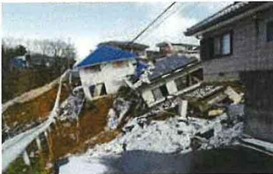
①あさひ台団地の法面崩落
