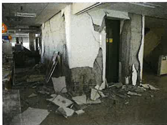
市役所庁舎の被災状況（２階）
