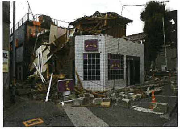
建物の被災状況（本町地内）
