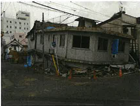
建物の被災状況（加治町地内）
